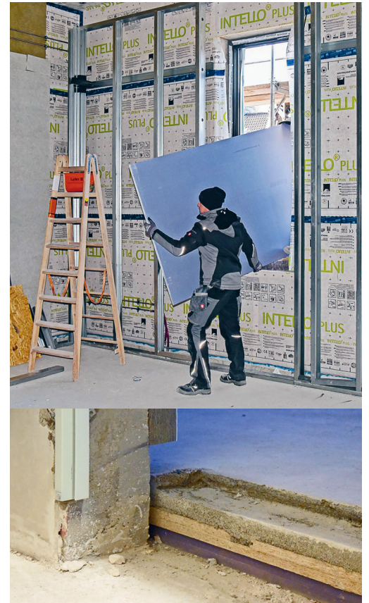
oben: Das Ständerwerk für die innere Wand entsteht unten: Blick vom Flur in ein Stimmzimmer. Erkennbar ist der mehrschichtige eingesetzte zweite Fußboden ohne Verbindung mit der Wand des Raumes. Außerdem die dicke Dämmung an der Innenwand des Stimmzimmers. Das Fußbodenniveau wird durch Dämmung und Estrich im Flur angeglichen werden
